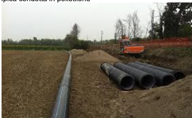
Tipica condotta in polietilene
