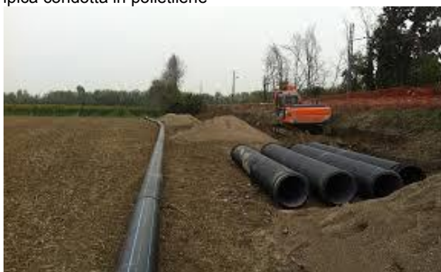
Tipica condotta in polietilene
